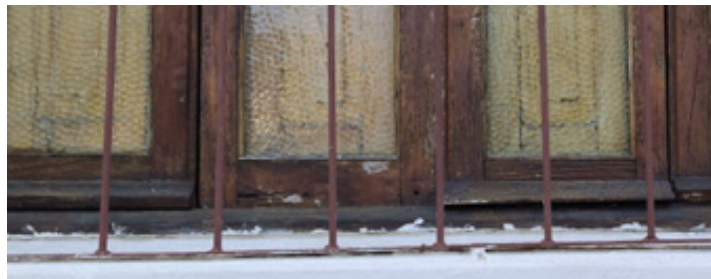
Figura 8- Foto de estufamento proveniente de umidade
