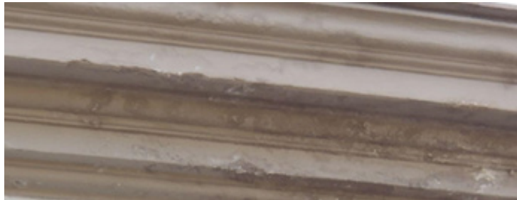
Figura 9- Foto da deterioração da janela
