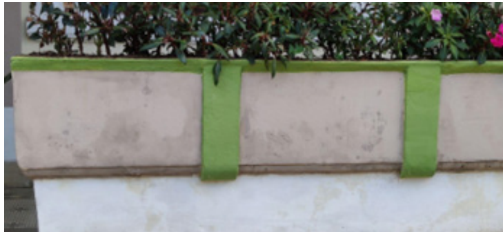
Figura 6- Foto do bolor presente em local de alta umidade.
