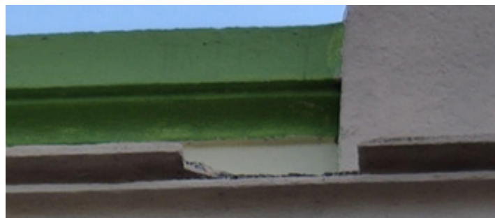
Figura 5- Foto do esborcinamento presente no edifício
