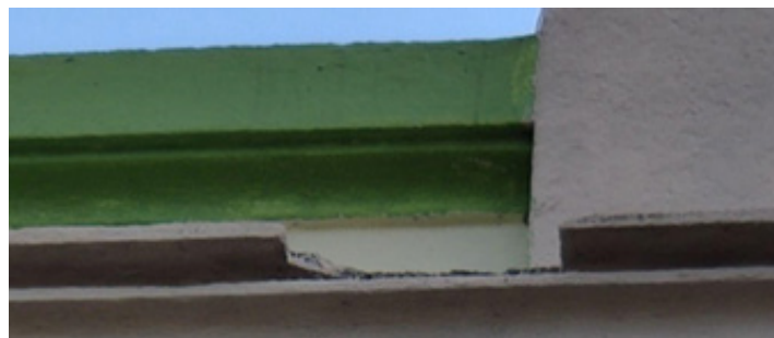
Figura 5- Foto do esborcinamento presente no edifício
