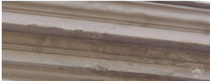
Figura 9- Foto da deterioração da janela
