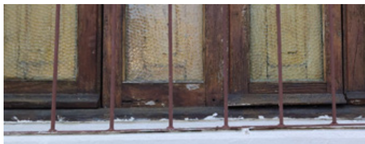
Figura 8- Foto de estufamento proveniente de umidade
